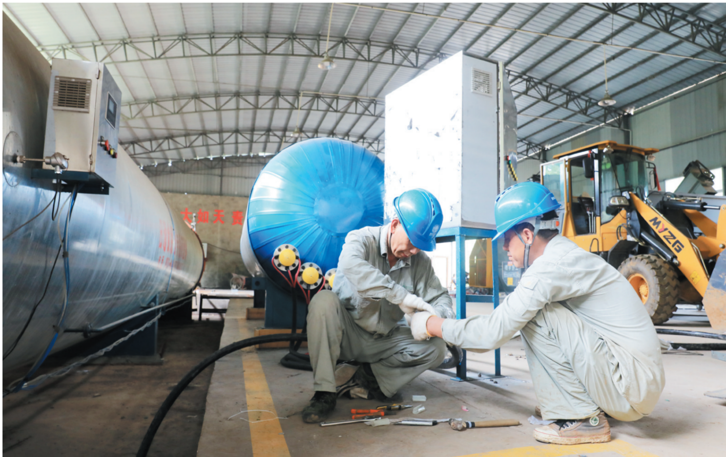
8月12日,国网曾都区供电公司洛阳供电所党员服务队来到龚店村香菇产业扶贫基地,为香菇菌棒制作厂的菌棒加热锅炉进行“煤改电”。架设线路、敷设电缆……服务队员们挥汗如雨,1天之内容改造工作,为制作厂节约生产成本,乡亲们脱贫增收提供了可靠的电力保障。(随州日报通讯员刘星雨摄)
