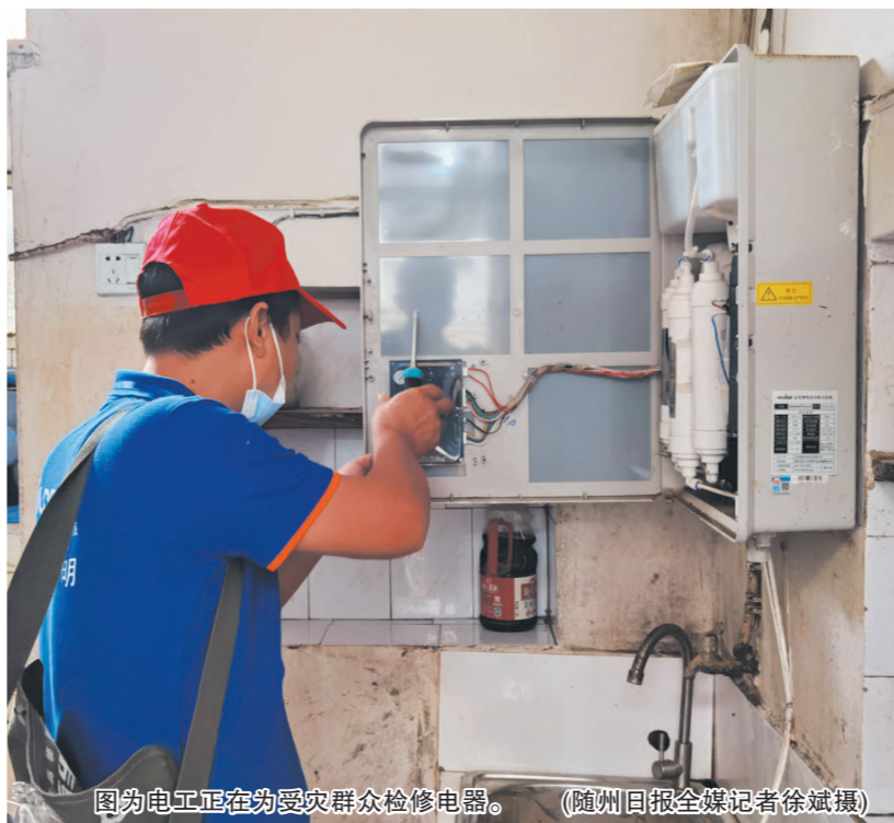
图为水电工正在为受灾群众检修电器。(随州日报全媒体记者徐斌摄)
